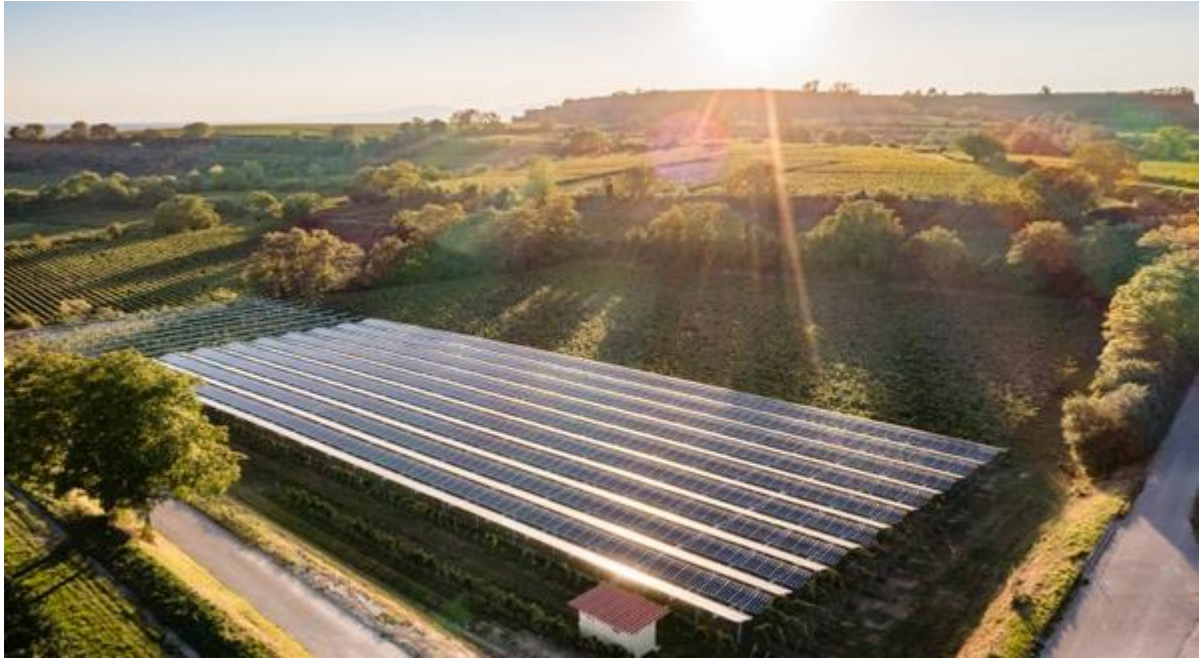
Quelle: Vino-PV Anlage am Tuniberg in Munzingen. Badenova AG & Co. KG
